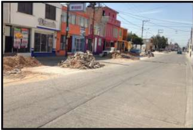
Fig. (28) Salazar C. Abril. 2014. Calle 71. Col. Cd. 2000, problemática con los escombros de concreto originados por la rehabilitación de calles.
