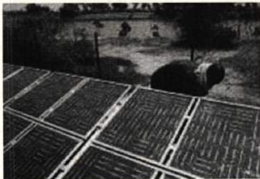
IMAGEN 1. Senegal: tablero solar para hacer funcionar una bomba de agua y regar el huerto con agua del río que aparece al fondo Senegal/18814/I Balderi
