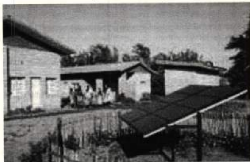
IMAGEN 2. Madagascar: tablero solar en un centro público de salud, recientemente dotado de un equipo fotovoltaico para iluminación y refrigeración de medicamentos y vacunas con energía solar Madagascar/17414/H. Wagner
